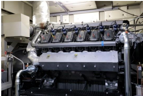
コージェネレーションシステム
